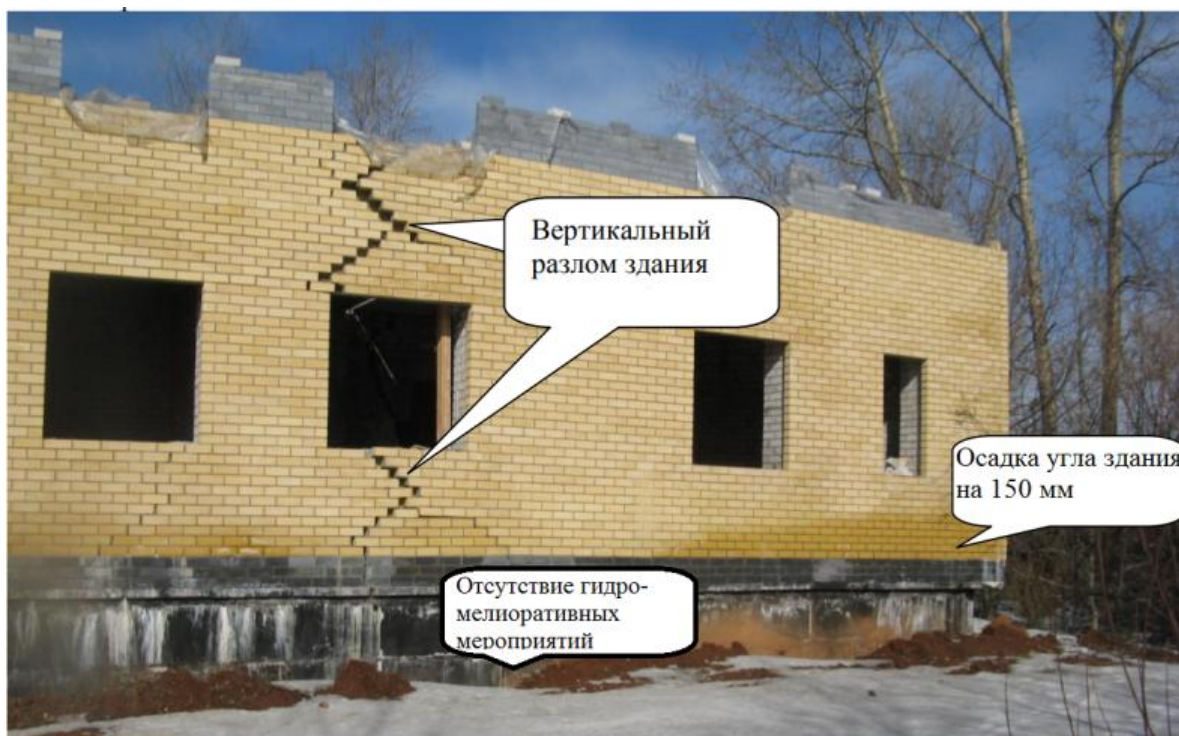
Рис. 2 – Разрушение здания вследствие неравномерных деформаций морозного пучения. Превышение первой группы предельных состояний: разрушения, потеря устойчивости формы, положения конструкций, сдвиг. По заключению экспертизы – аварийное состояние, не подлежащее усилению, восстановлению.
