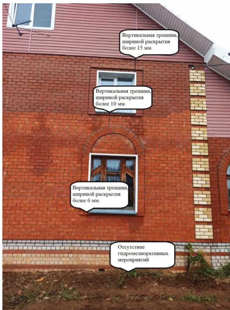
Рис. 3 – Деформация здания вследствие неравномерной осадки фундамента, как результат морозного пучения грунта основания. Превышение второй группы предельных состояний: достижение предельных осадок фундамента, достижение предельных раскрытий трещин. По заключению экспертизы – ограниченно-работоспособное состояние. Разработан проект по усилению фундамента, выполнению тепло- и гидромелиоративных мероприятий (создано авторами)
