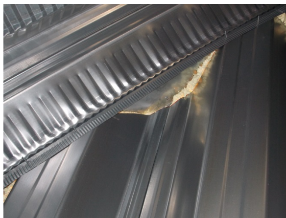
Рис.2 Наличие зазоров между аркой и стеной
