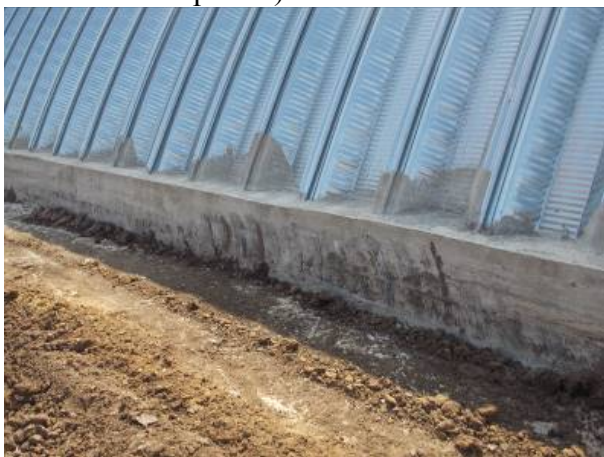
Рис.5 Отсутствие гидроизоляции железобетонного ростверка (Пензенская область, Мокшанский район)
