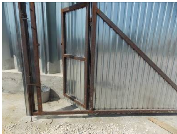
Рис.6 Отсутствие лакокрасочного покрытия конструкции ворот (Пензенская область, Мокшанский район)
