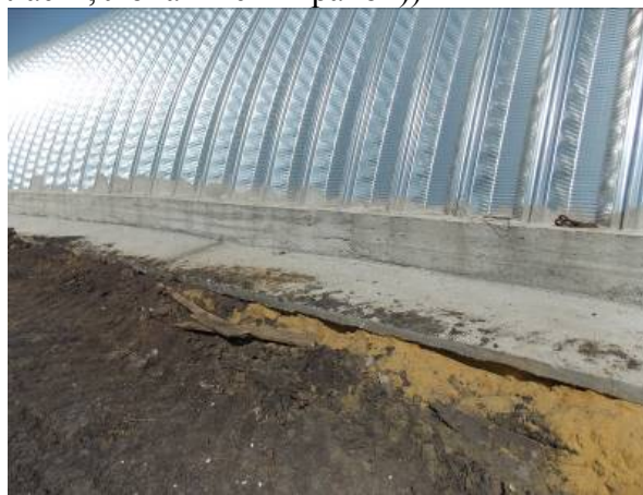
Рис.4 Вымывание основания отмостки; (Пензенская область, Мокшанский район)
