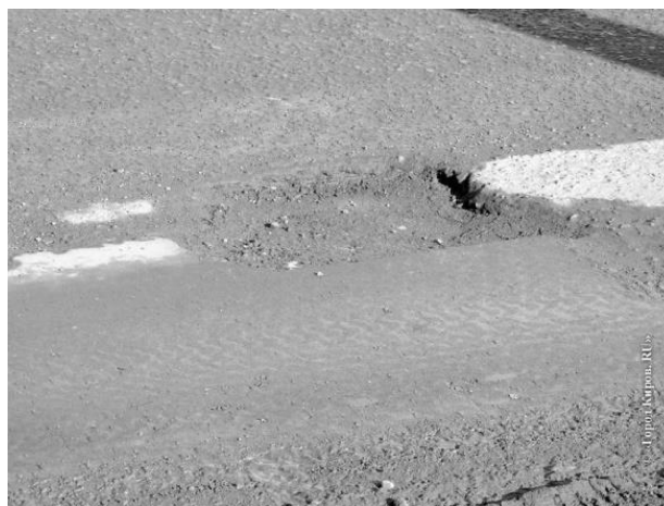
Рис. 2 – Пример неполной захватки поврежденного покрытия
