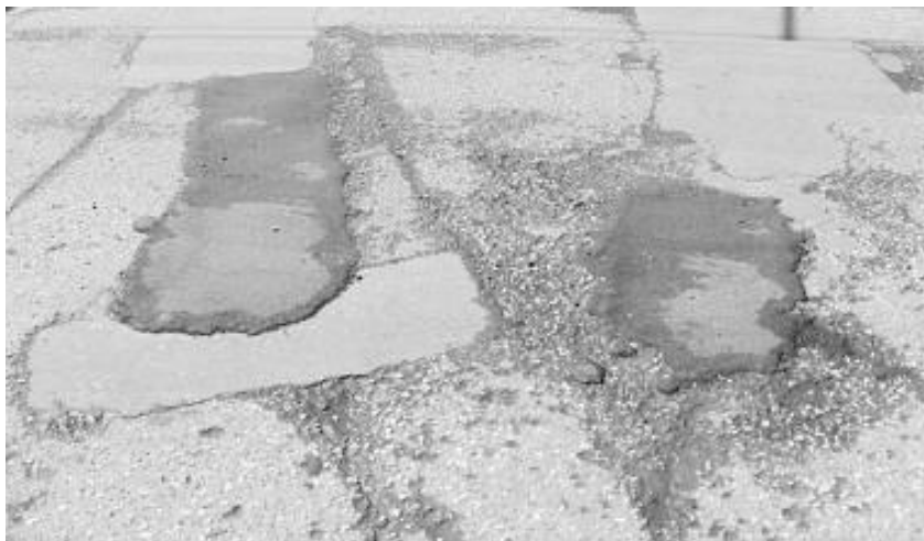
Рис. 3 – Пример укладки карт с предварительной вырубкой фрезой (ранее уложенные карты) и без надлежащей вырубки (свежеуложенные карты); наглядно показано отсутствие очистки кромки перед уплотнением (образование валиков на стыке существующего полотна и карты)
