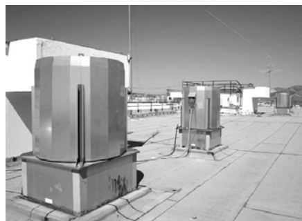
Рисунок 6. Крышной вентилятор механического дымоудаления с вертикальным выбросом на монтажном стакане.
